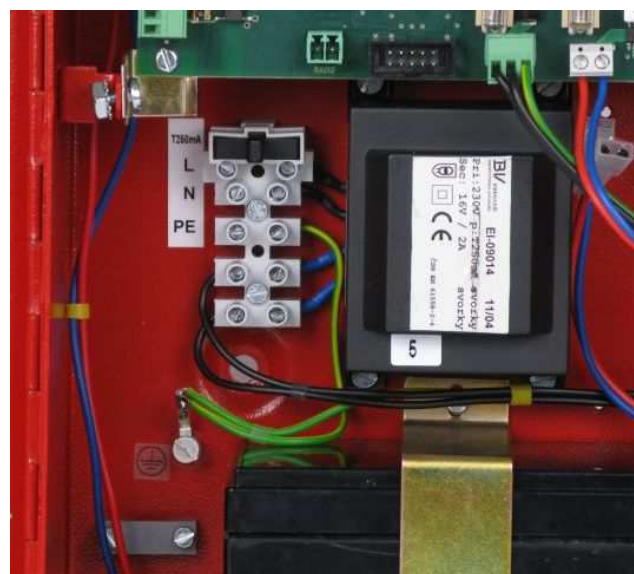
Obr. 4 - svorkovnice připojení síťového napájení
