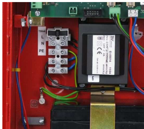
Obr. 5 - svorkovnice připojení síťového napájení
