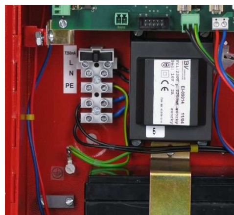
Obr. 5 - svorkovnice připojení síťového napájení
